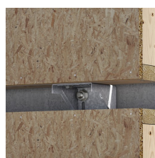
Fijación de la pared en la parte inferior, en la cara de la losa
