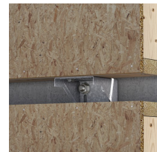
Holzkonstruktion unter dem Konsolwinkel an der Deckenschmalseite.
